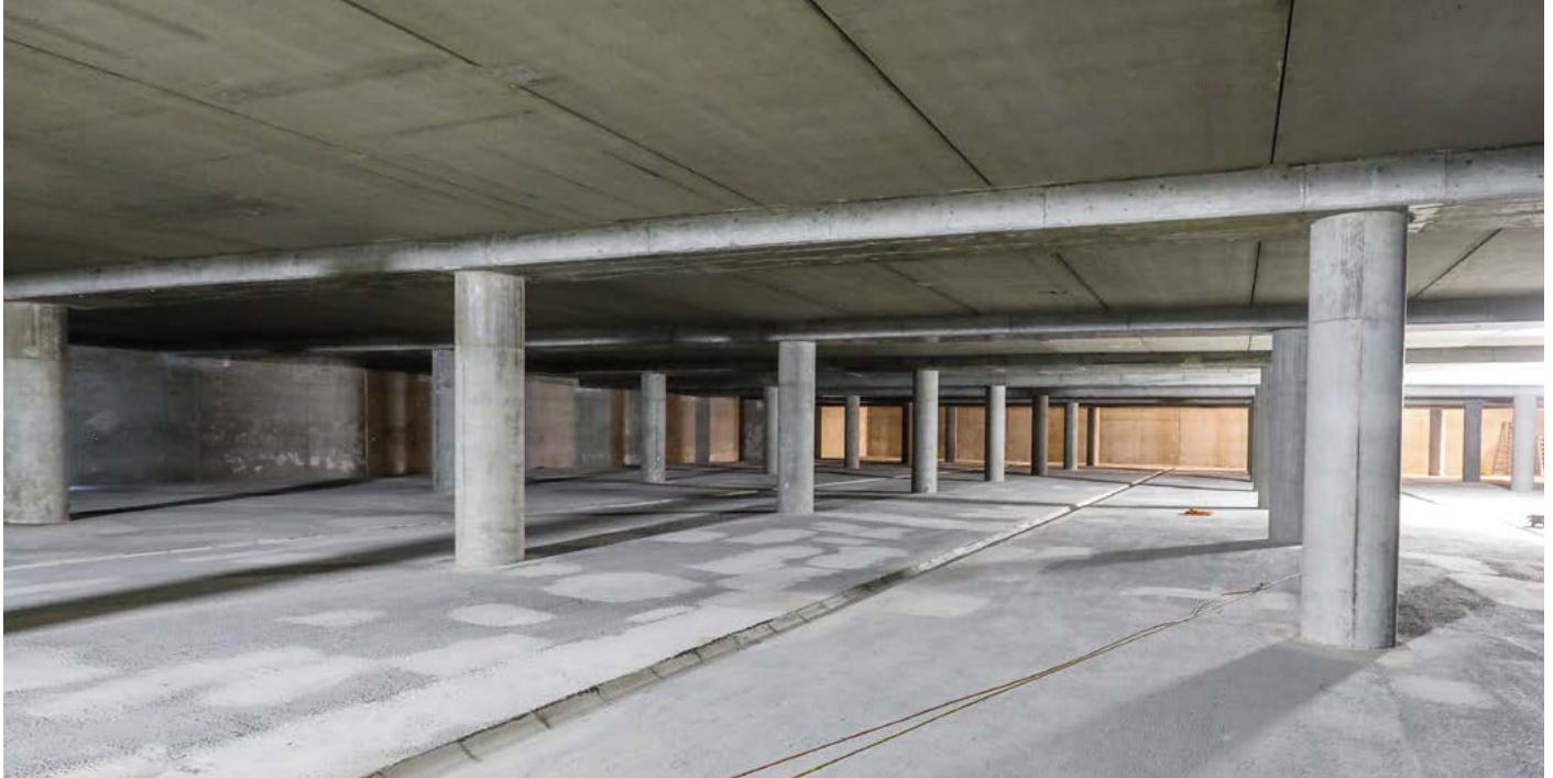
Im Speicherbecken können zehn Millionen Liter Regenwasser gesammelt werden.
