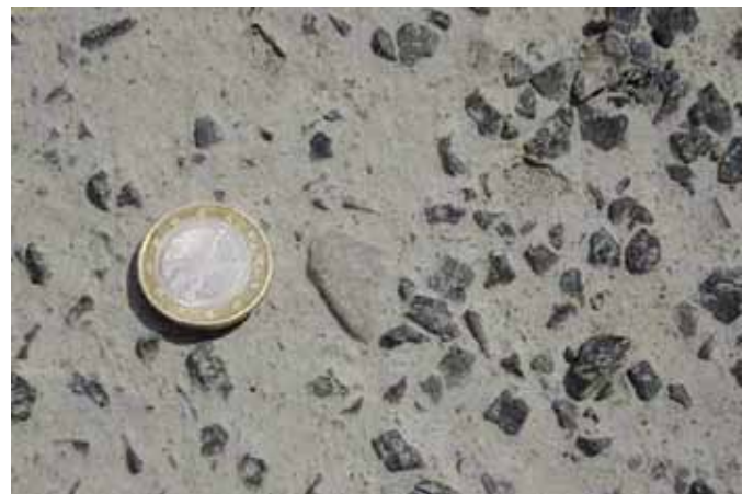
Abb. 2: Betondecke mit fehlerhafter Waschbetonstruktur
