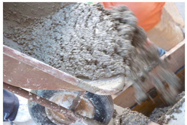
Abb. 19: Freie Fallhöhen von mehr als 1 m vermeiden
