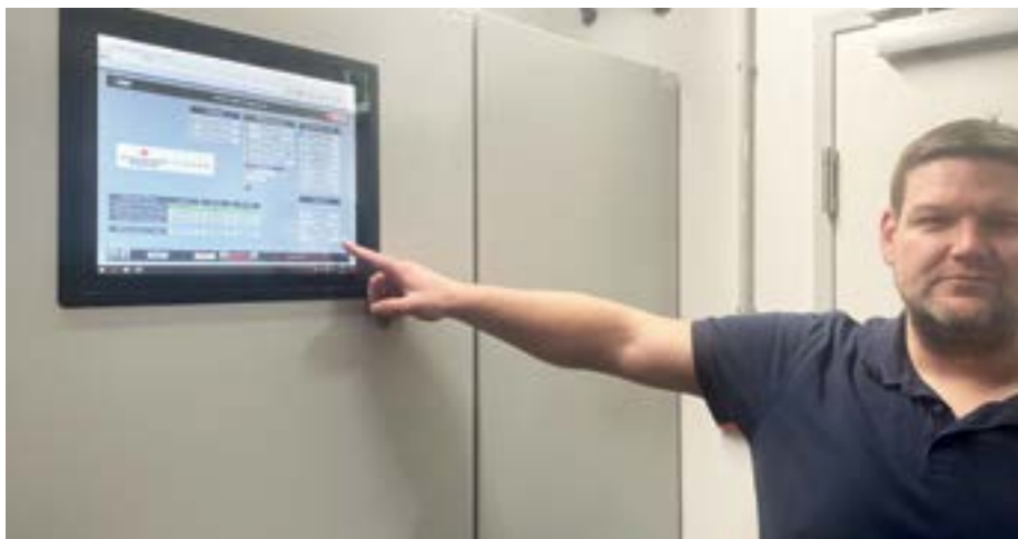
Alles im Griff – Christoph Stadtschmitzer sieht auf dem Display in der Haustechnikzentrale genau, wo gerade geheizt oder gekühlt wird.
