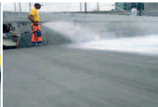
5 Wird der Nachbehandlung des Betons nicht genügend Aufmerksamkeit geschenkt, ist alle Mühe umsonst. Das Aufsprühen eines Curing Compounds schützt den Beton vor vorzeitiger Austrocknung.
