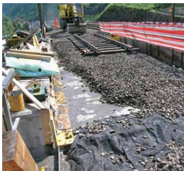
Abb. 3 Einbau Bahnschotter und Gleisrost auf UHFB-Abdichtung; linker Bildrand: Negativschalung für vertikale UHFB-Fläche am Randbord
