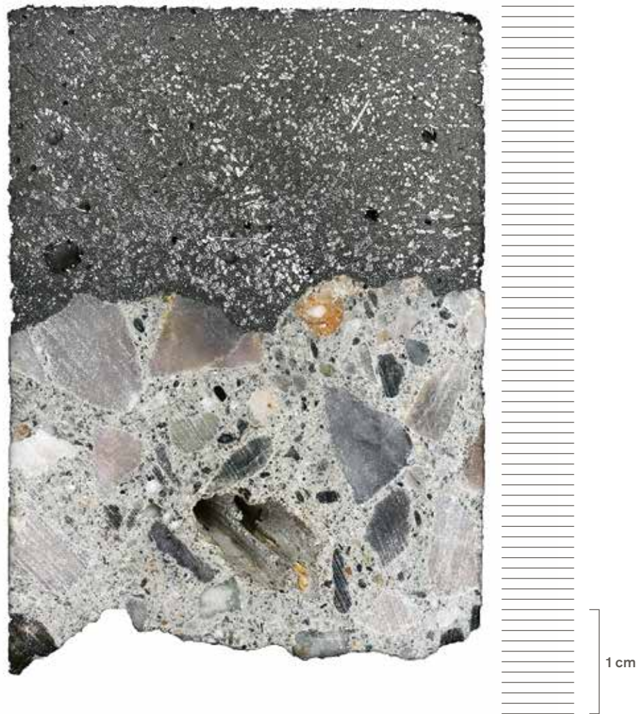
Abb. 1 Auflichtbild einer Kontaktzone zwischen Beton und UHFB. Deutlich sichtbar der Unterschied der Baustoffe (Grösstkorn, Faserbewehrung, Dichtheit)
