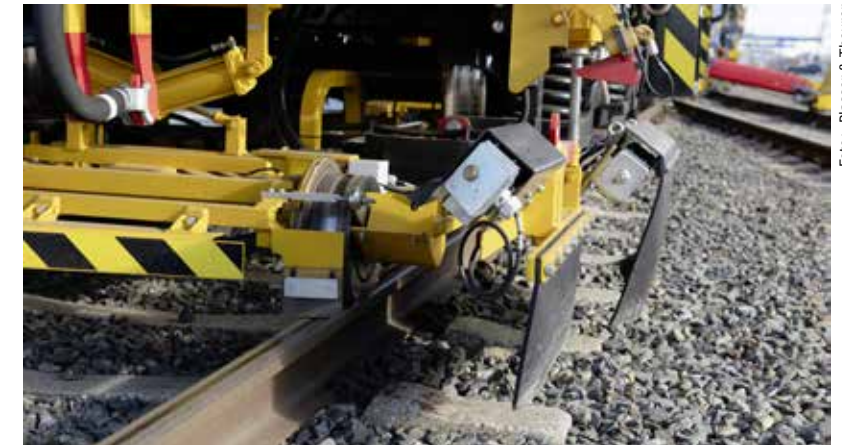
Live-Erkennung und Klassifizierung von Hindernissen und Weichenkomponenten während der Arbeitsfahrt mit dem TampingAssistant.
