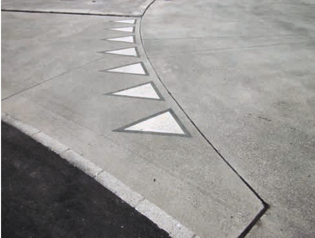
Waschbetonoberfläche nach einem Jahr unter Betrieb
