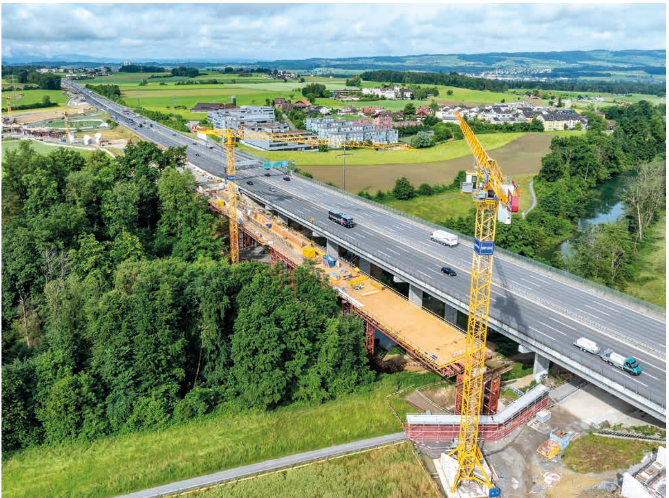
Die Lorzentälbrücke im Frühling 2025: Auf dem Lehrgerüst (rot) wird die Überdeckung erstellt.
