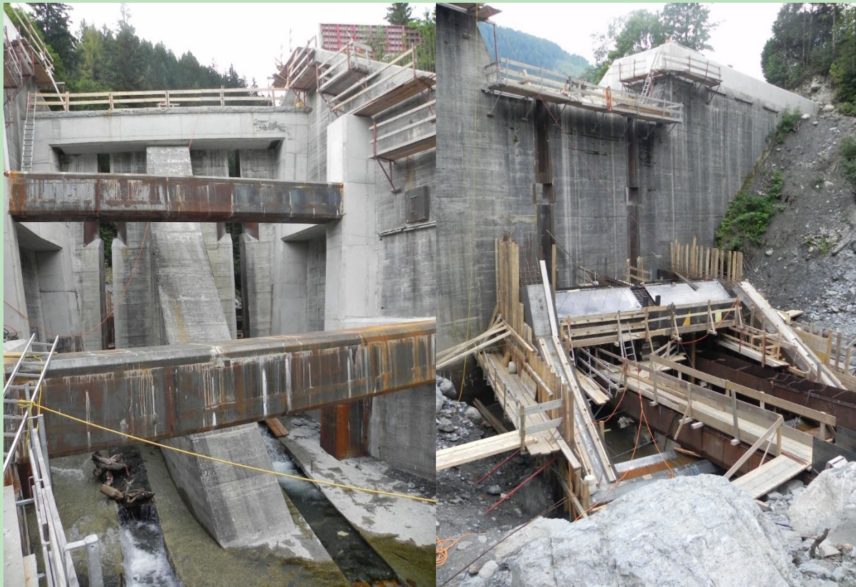
Beispiel Anpassung und Systemintegration von Schutzbauwerken im Trattenbach (Salzburg): Integration eines Rechens an eine bestehende Schlitzsperre und Durchzüge zur Aussteifung der nicht standsicheren Vorfeldscheiben.
