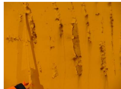
Längliche Abplatzungen besonders in Portalnähe
