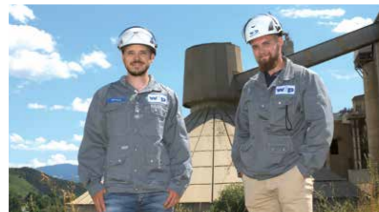
Teamleiter mit starken Nerven: Daniel Werhonig (links) und Michael Kuester (rechts) betreuen den Einbau der Filteranlage in nur fünf Wochen.
