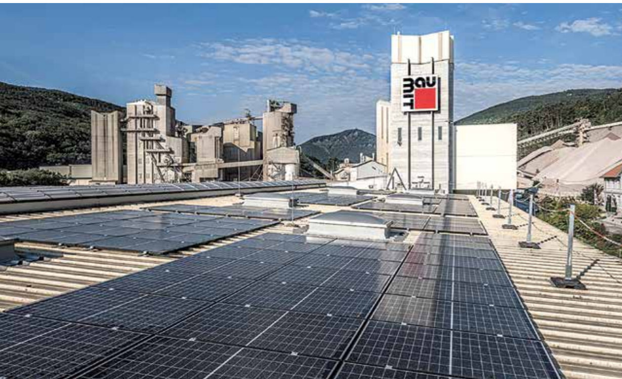
Auf dem Nassproduktwerk in Wopfing wurden 1.800 m 2 PV-Paneele installiert, welche 350 MWh Solarstrom im Jahr liefern.
