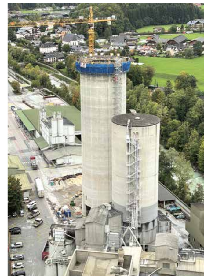
Mehr Lagerplatz vor Ort: Mit dem neu gebauten Zementsilo bei Leube in Hallein kann die Produktion flexibler gestaltet und erneuerbare Energien besser genutzt werden.
