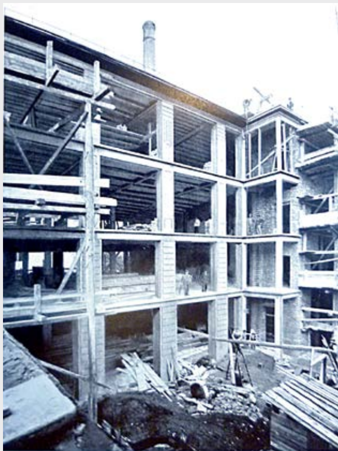
Werkstättengebäude. Hoffassade, in welcher alle Pfeiler, Fensterüberlagen usw. im anstimmigen Beton-System Ast & Co. ausgeführt sind.
